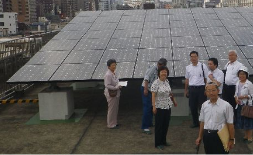
大森第一小学校屋上の太陽光パネル
